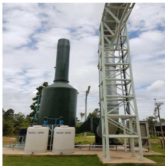
เครื่องกำจัดกลิ่นอาคารคัดแยกขยะมูลฝอย
