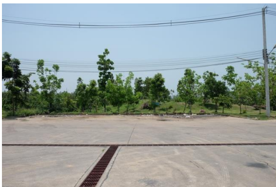
ลานล้างรถขนขยะมูลฝอย
