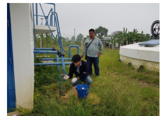
ท่อจ่ายน้ำ
