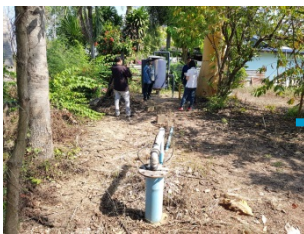
บ่อบาดาลและ เครื่องสูบน้ำ
