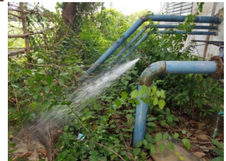
ท่อจ่ายน้ำ
